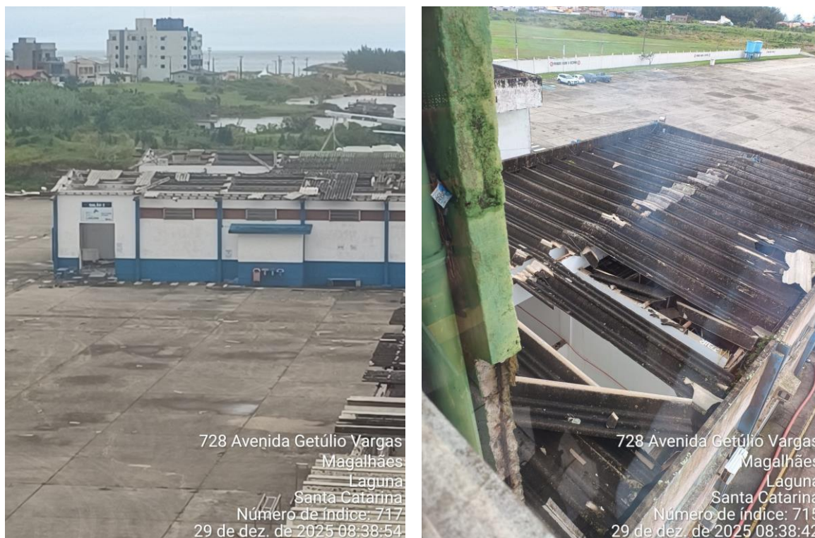
Figura 3 e 4 – Avarias na cobertura das edificações do Porto de Laguna
